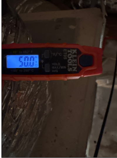
B. Item 5 Supply Side
